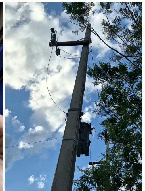
Stromversorgung mit eigenem Trafo
