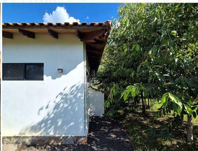
Gasflaschenhäuschen auf der Hinterseite außen
