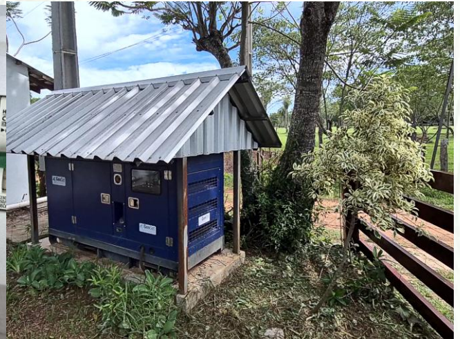
eigener Notstrom mit Sonnen- und Regenschutz
