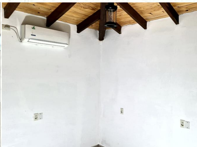
Raum 5, ebenfalls mit eigener Klimaanlage
