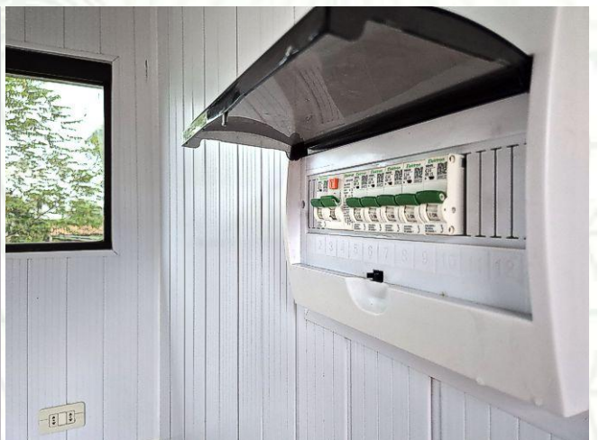
moderne, sichere Elektroinstallation
