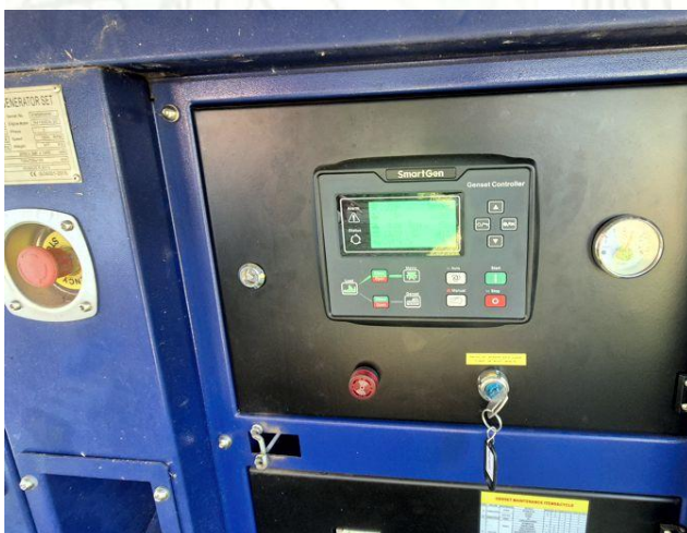
Strom und Notstrom vollautomatisiert
